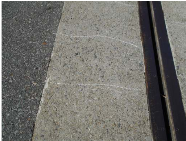
A1 후타재 균열(0.3mm이상)
