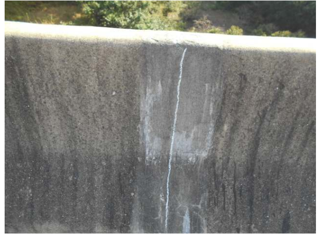
S3 방호벽 균열(0.3mm이상)
