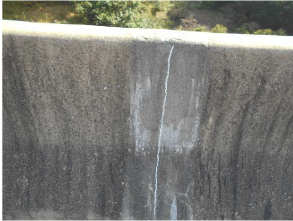
S2 방호벽 균열(0.3mm미만)
