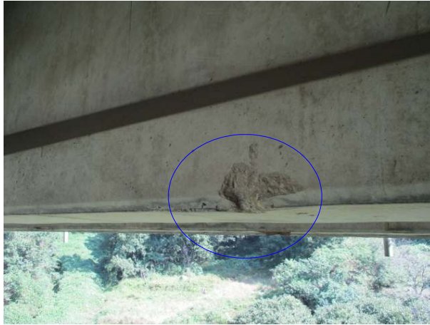
(S3 G4) 거더 측면 Con'C파손
